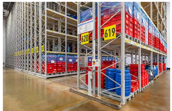
Jedes einzelne Bauteil der 10.700 mm (Absetzhöhe) hohen und 16 bzw. 10 Meter langen Regale ist mit der Oberflächenbeschichtung OR 6000® vor der Salzlake geschützt. (Foto: www.kaiser-fotografie.de)
